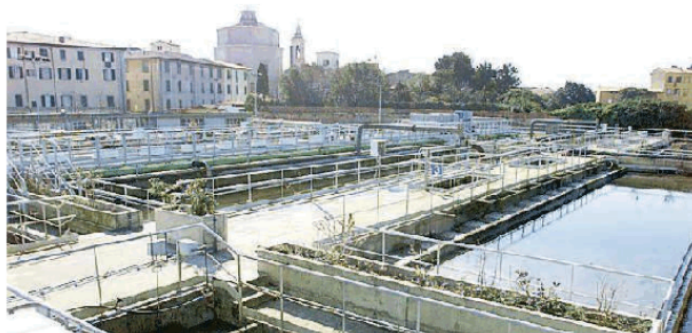
Il depuratore del Rivellino (PENTAFOTO)
